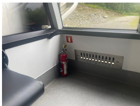
搬器 2 階部 消火器
